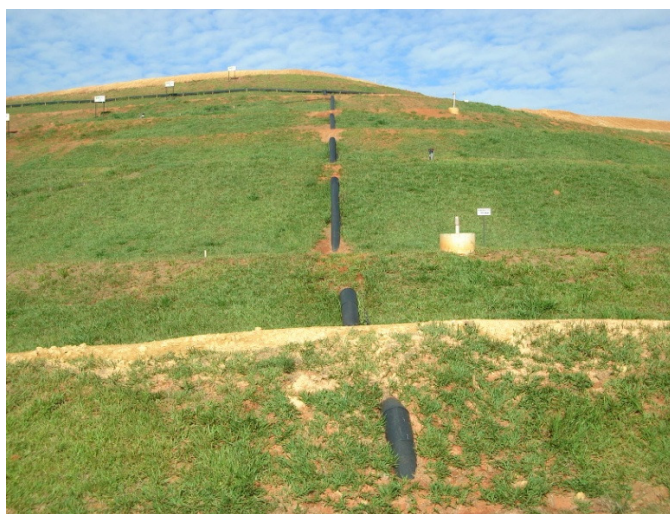
Figura 5 - Exemplo de tubulações de transmissão
