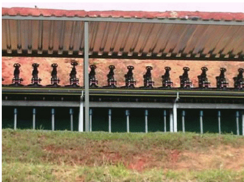
Figura 3 – Exemplo de sistema de controle (manifolds)
