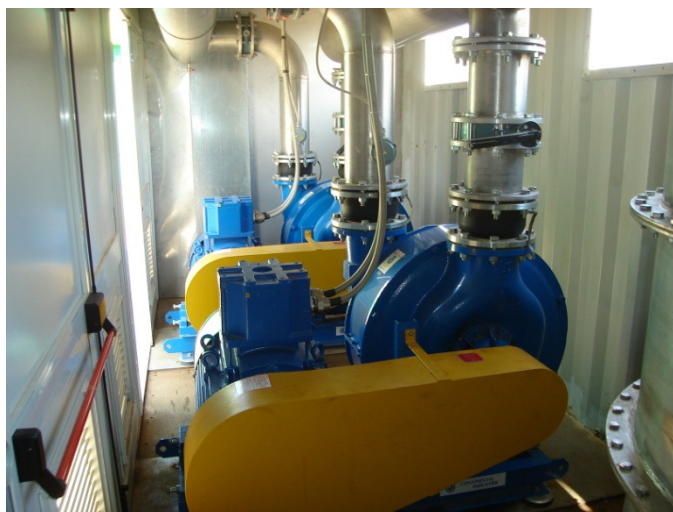
Figura 6 - Exemplo de sistema de sucção Fonte: ESTRE Ambiental S.A.
