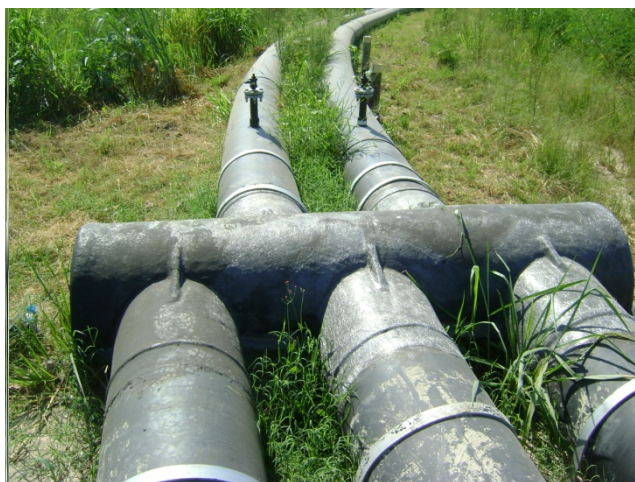
Figura 6. Exemplo de tubulação de transmissão mostrando um plenum que permite a duplicação do diâmetro efetivo da tubulação (Fonte: Aterro Sanitário Jardim Gramacho)
