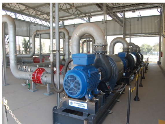
Figura 7. Exemplo de sopradores instalados na Novo Gramacho Ambiental.
