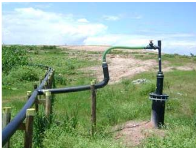
Figura 5. Exemplo de cabeçote de controle de vazão interligado a linhas laterais de transporte, Aterro Sanitário de Gramacho
