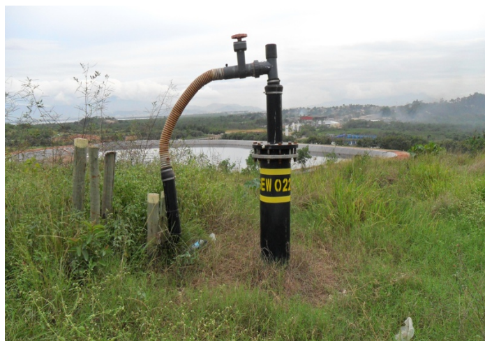
Figura 3 - Exemplo de cabeçote, Aterro Sanitário de Novo Gramacho
