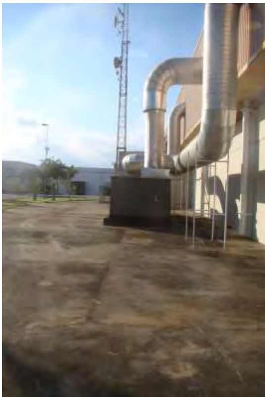
Local do futuro gerador de 100 KVA, instalações do tempo.
