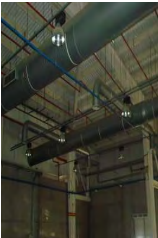
Detalhe das instalações de ar condicionado, da iluminação e tubulação de combate a incêndio.
