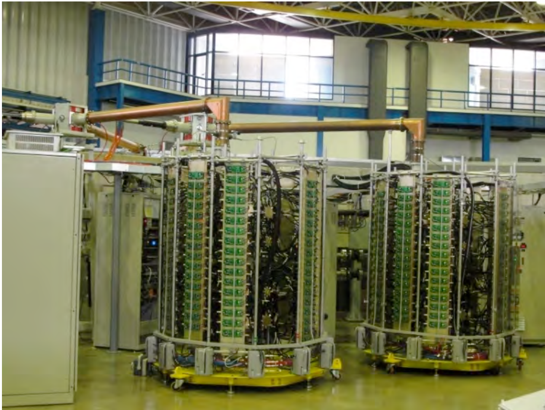
Figura 1: Amplificadores de Estado Sólido , instalados e em operação no anel de armazenamento da Fonte de Luz Síncrotron do LNLS. Cada amplificador pode fornecer até 50 kW de potência na frequência de 476 MHz. Os amplificadores foram projetados e construídos no LNLS.
