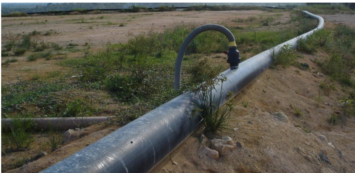
Figura 6 - Exemplo de tubulações de transmissão
