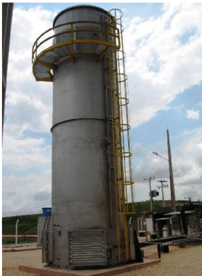
Figura 9 - Detalhe do flare fechado
