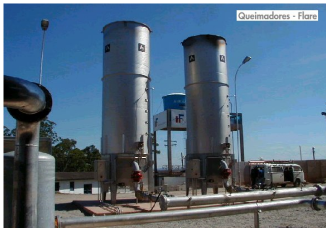
Figura 7. Exemplo de flares (fonte: Biogás Ambiental)
