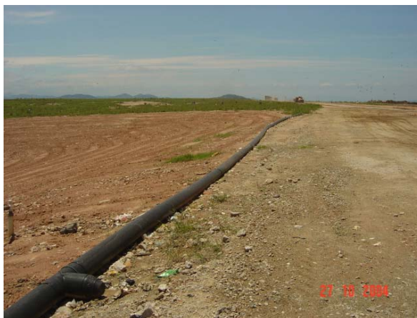
Figura 6. Exemplo de tubulação de transporte de biogás
